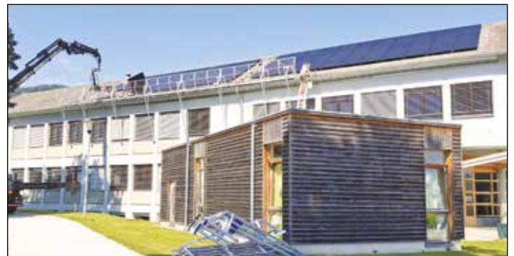
Die Photovoltaik-Anlage auf der VS Kraig liefert bereits saubere Energie für die Gemeindegebäude.
